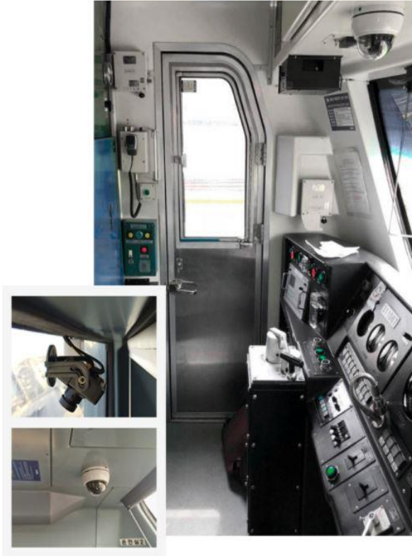
한국철도공사 영상기록장치 설치
